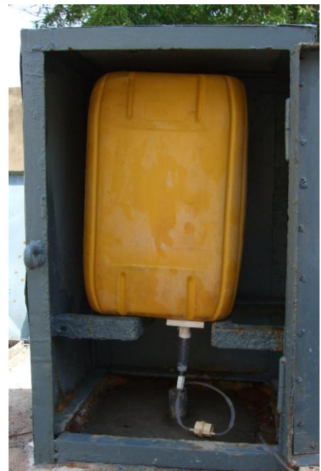
Dispositif placé au dessus du réservoir.
